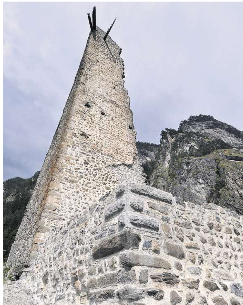
Statisch gesichert: Die einsturzgefährdete Turmnadel auf dem Felsen von Juvalt steht heute wieder auf festem Fuss. Bild Jano Felice Pajarola
